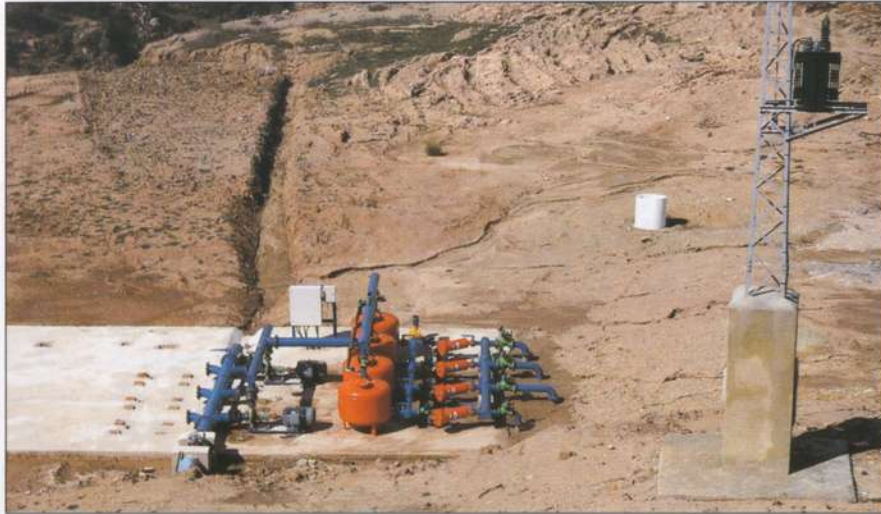
Άποψη ενός σταθμού φιλτραρίσματος νερού για άρδευση σταγόνα-σταγόνα. Εγκαταστάθηκαν φίλτρα άμμου και φίλτρα από σίτες για την εξασφάλιση ορθής λειτουργίας της εγκατάστασης.
