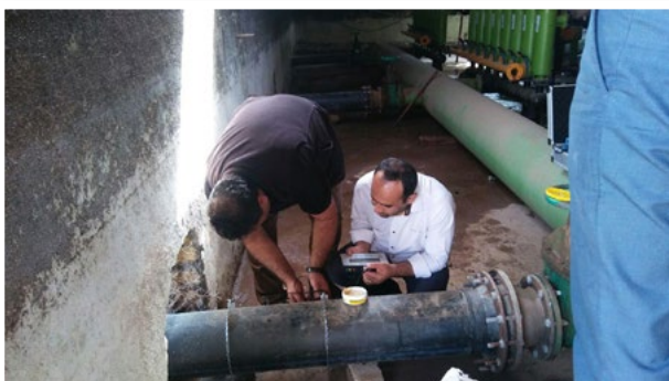
Illustration 1 Suivi du débit de déversement à l'entrée du poste de contrôle central à l'aide d'un débitmètre à ultrasons
