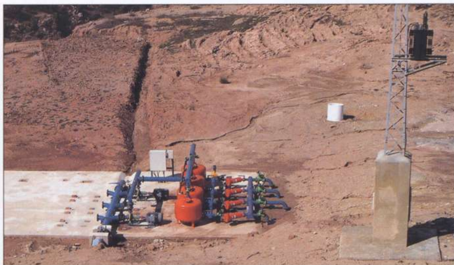
Panoramica di un impianto di filtraggio di acqua per irrigazione goccia a goccia. Sono stati installati filtri di sabbia e filtri a rete per assicurare il corretto funzionamento dell'impianto.
