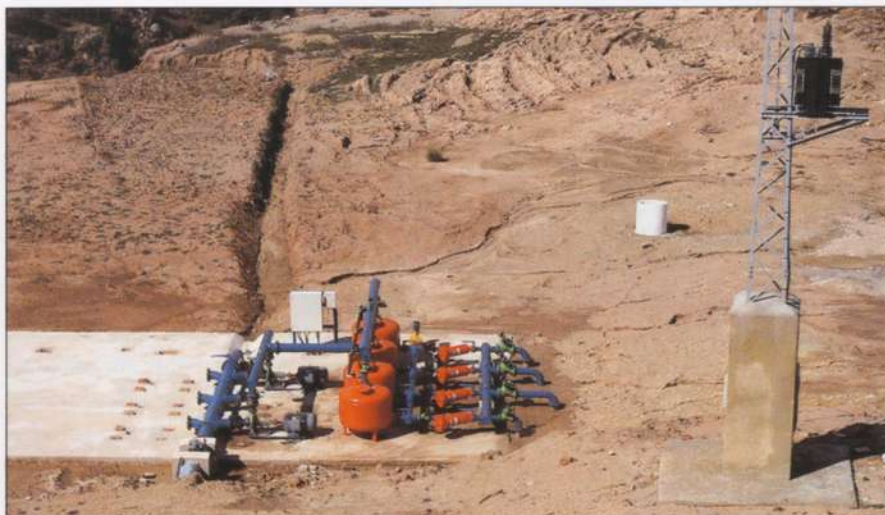
Panorâmica de uma estação de filtragem de água para rega gota a gota. Instalaram-se filtros de areia e filtros de rede para assegurar o correcto funcionamento da instalação.
