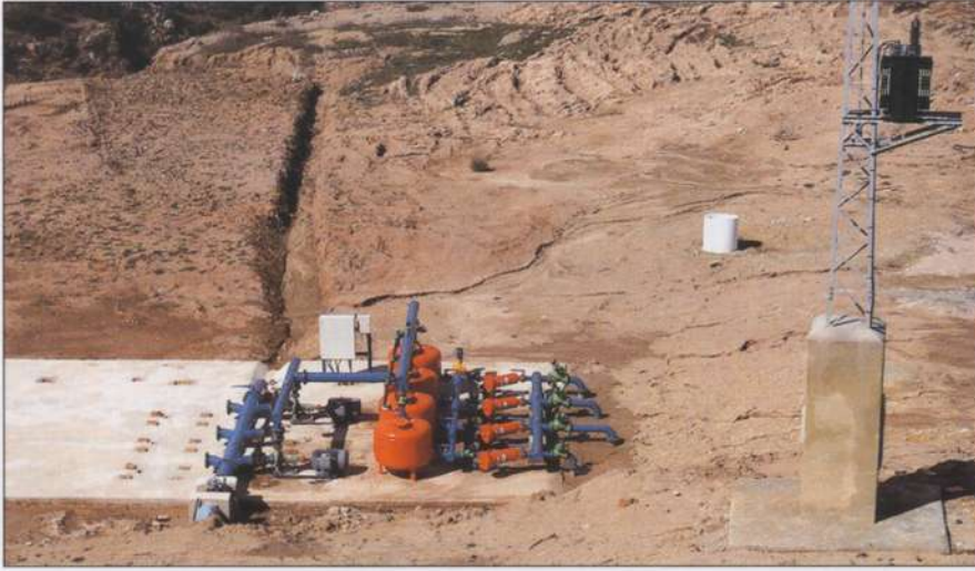
Damla sulama için su fi ltreleme tesisi. Kova ve elek fi ltreler kullanılarak tam çalışma sağlanır.
