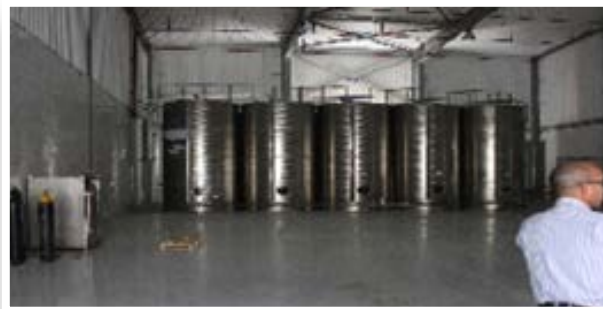
Fig. 4 : Réservoirs de stockage en acier inoxydable
